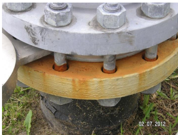
Abb.2: Korrosion an Schraubverbindungen in den unteren Löchern waagerechter Flansche in Außenanlagen Quelle: Peter Thomsen
