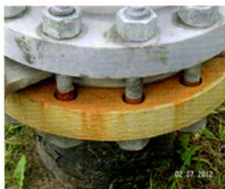
Bild 1: Korrosion an Schraubverbindungen in den unteren Löchern waagerechter Flansche in Außenanlagen (Bild: Peter Thomsen)
